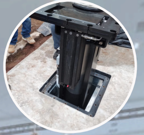
Utilizan pozo o casquillo de acero galvanizado
